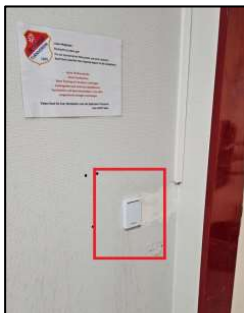
Kontaktfläche Transponder GetFit (1. Etage)
